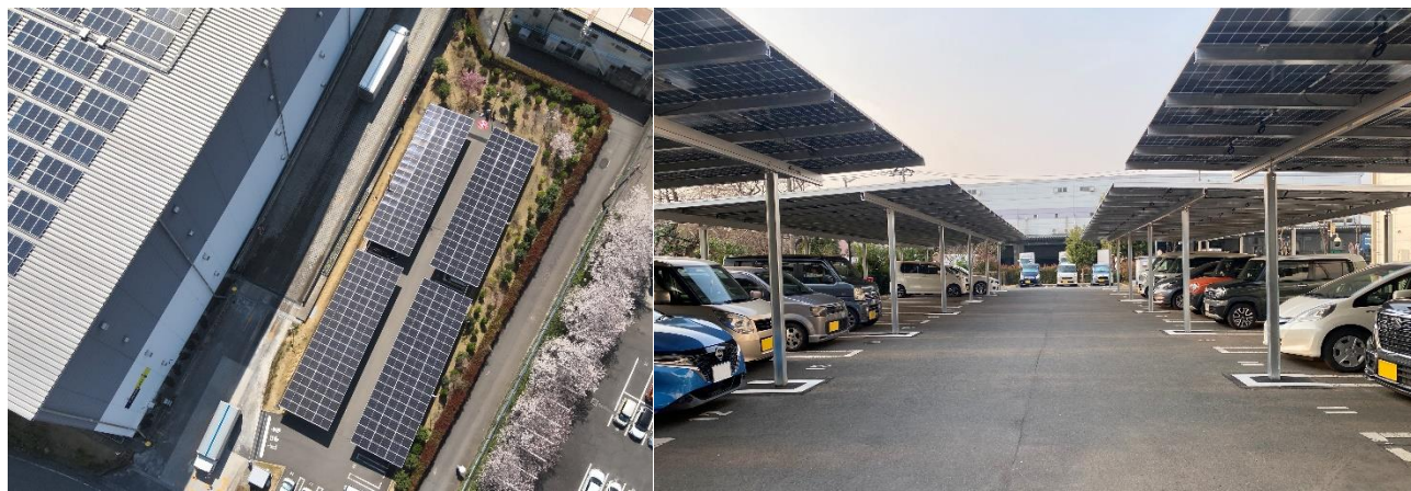
【ソーラーカーポートを設置した Landport 厚木金田】
