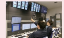
BLUE FRONT SHIBAURA TOWER S 防災センター
